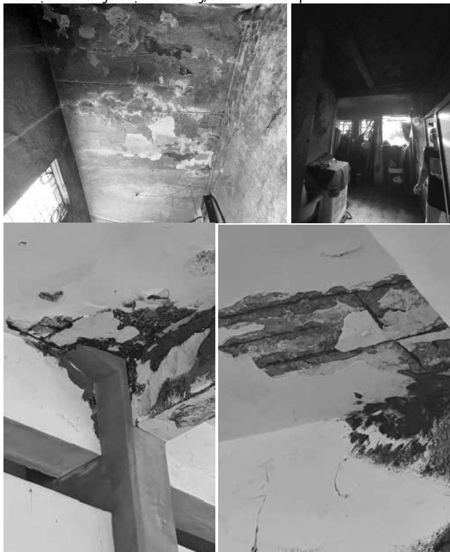
Hình 13. Không chỉ gây khó khăn cho sinh hoạt cuộc sống, thấm dột còn gây ra sự hư hại nghiêm trọng đến hệ kết cấu công trình, đặc biệt là cốt thép
