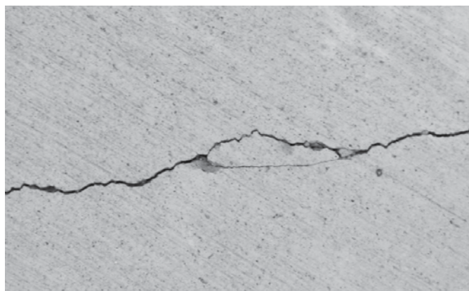
Hiện tượng nứt do thi công gạch không nung không đúng quy trình (ảnh minh họa)
