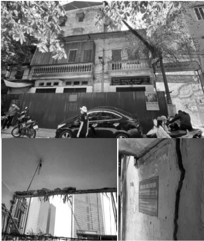
Hình 15. Trước toà nhà đã được Cơ quan chức năng phường Cống Vị treo biển cảnh báo sự nguy hiểm, yêu cầu cư dân sớm di dời
