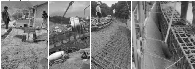
Hình 7. Biến dạng giàn cốp pa chống đỡ mái và bê ván khuôn thành khi đang thi công đổ bê tông
