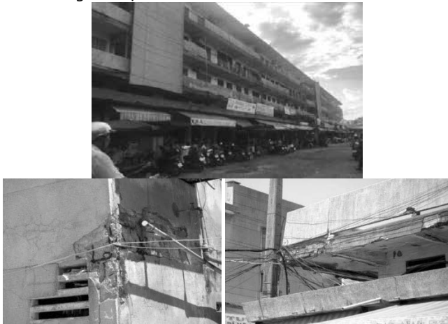
Hình 20. Được xây dựng từ năm 1972-1975 (Vạn Thạnh, Nha Trang) bao gồm 2 block A và B, hiện đang xuống cấp trầm trọng nhưng vẫn chưa được đầu tư di dời, xây dựng lại
