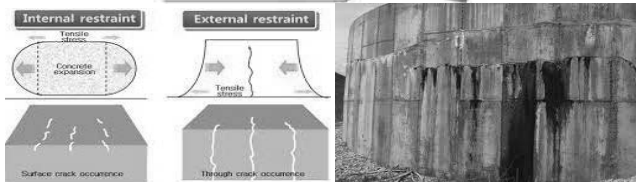
Hình 6. Bê tông bị nứt do nhiệt của bê tông khối lớn
