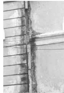
Hình 12. Ống nước nứt vỡ [1]
