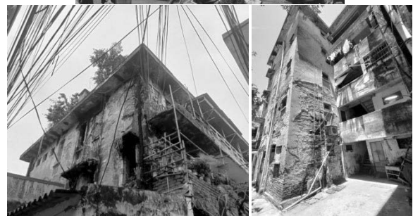
Hình 1. Các toà nhà tập thể “Công nhân Thủy tinh”, “Trần Đăng Ninh” hiện đã xuống cấp sau 50 năm sử dụng tại Hải Phòng và Nam Định
