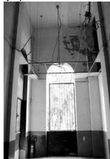
Hình 11. Hệ thống dây điện chằng chịt [1]
