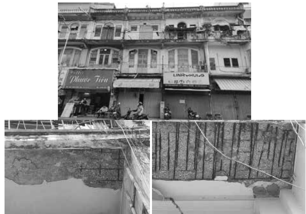
Hình 22. Được xây dựng từ khoảng 1970-1975 (phường 11, quận 5), do chất lượng sử dụng chất ngoài kém chất lượng và chiều dày quá mỏng nên cốt thép sớm bị lộ thiên và han gỉ
