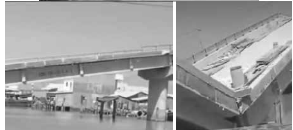
Hình 10. Cầu bị gãy, sập do bị quá tải
